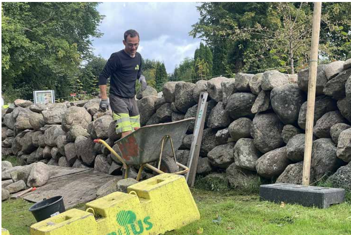
Jesper Buch fra Buus Anlægsgartner i gang med genopretningen. Foto: Hans Petersen
