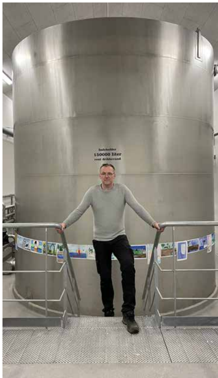
Vandværket er velfungerende. Her er driftsleder Michael Laursen ved en af de store tanke med rent vand. Foto: Hans Petersen
