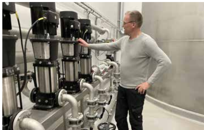
Michael L. Laursen er driftsleder for Mårslet Vandværk. Her holder han styr på de mange rør i vandværkets bygning på Gammel Bedervej. Foto: Hans Petersen
