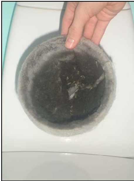
'Lungen' – ventilationsanlæggets filter – er sort af fedtede sodpartikler. Gennem filteret går 'den friske luft', som trækkes ind udefra.
