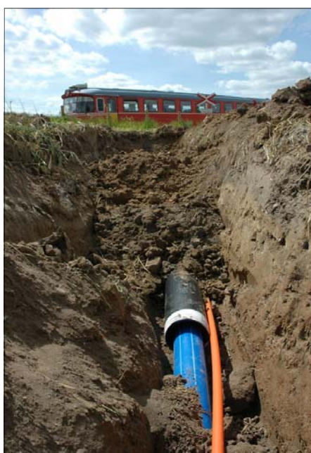
Parallelt med vandledningen lægges et tyndere servicør med kabler til styreformål o.a.
