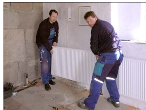
VVS teknikerne Chr. Omø Sørensen og René Mejer Nielsen monterer her den sidste af de i alt tre radiatorer, der nu skal erstatte elvarmeovnen.
